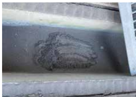
①側溝に溜まった改良土のホコリ
