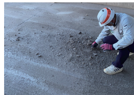
③焼却灰の清掃（発電所）
